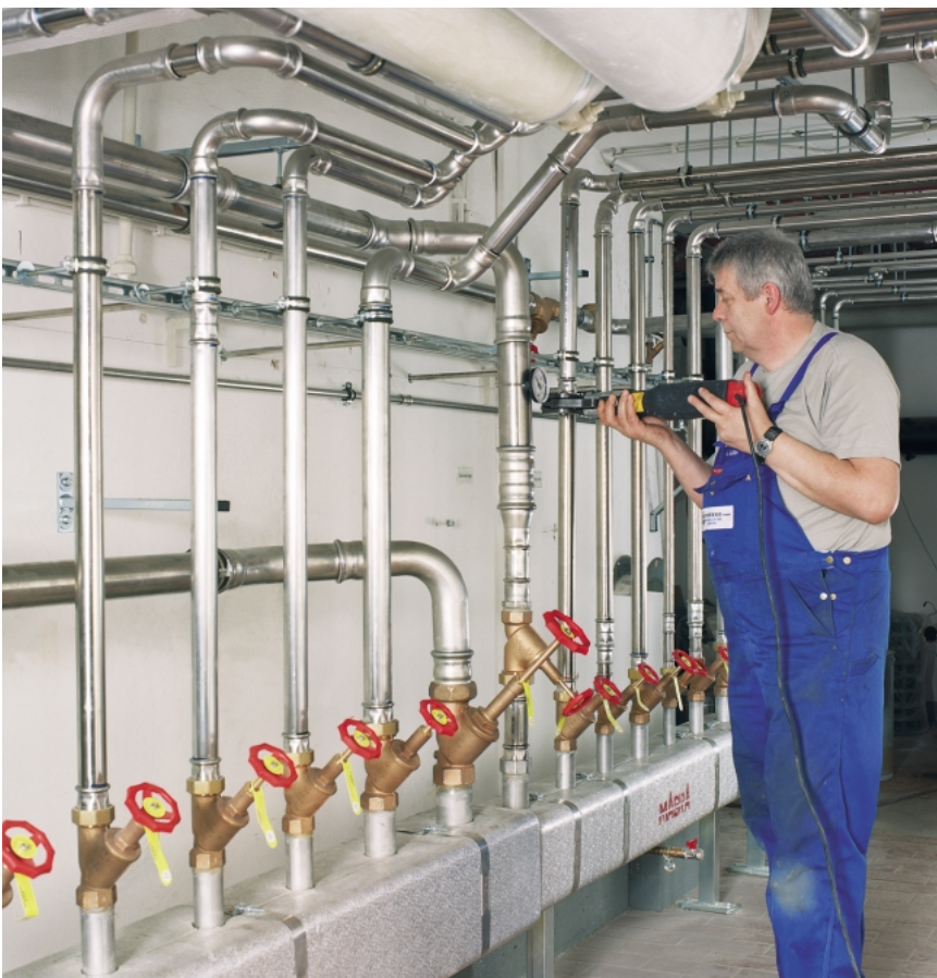
Bild 10: Technische Gebäudeausrüstung im Euregio Outlet Center Ochtrup mit Edelstahl Rostfrei-Rohren und Edelstahl Rostfrei-Pressfittings in Verbindung mit Rotguss-Ventilen (Foto: Geberit Vertriebs GmbH, Pfullendorf)
