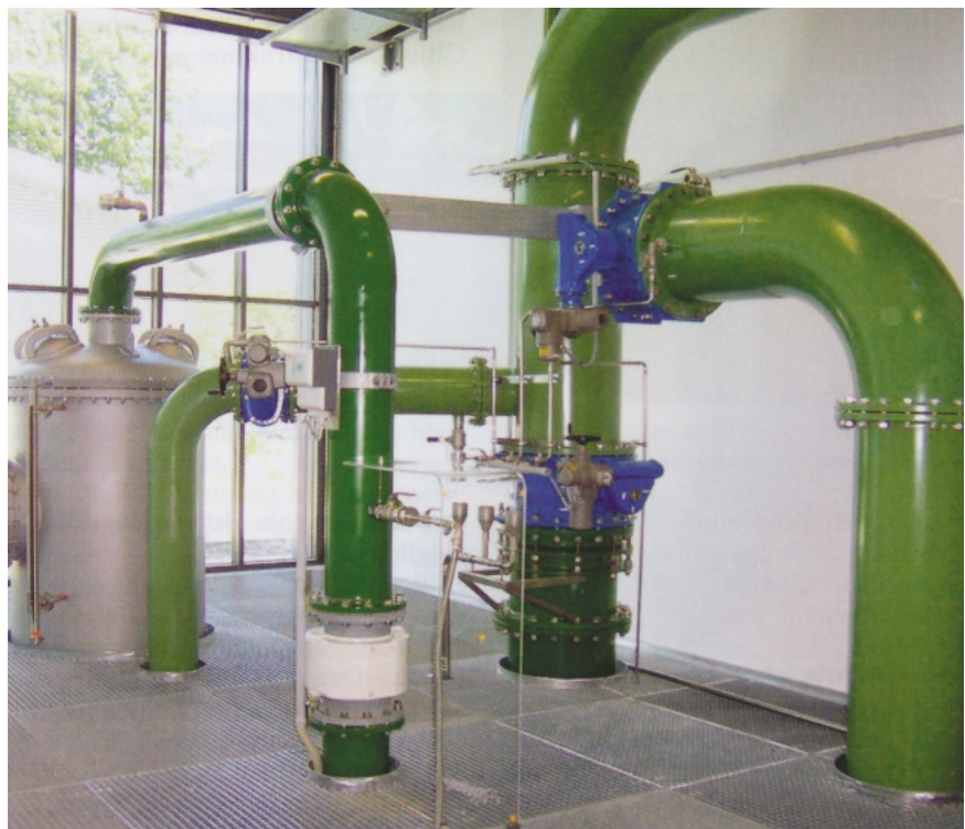
Bild 8: Oxidator aus nichtrostendem austenitischen Stahl 1.4571 im Wasserwerk Curslack für die Anreicherung von Rohwasser mit technischem Sauerstoff zur vollständigen Oxidation von zweiwertigem Eisen und Mangan sowie des Ammoniums, mit Einbindung an die Rohwasserleitung. Die wasserführenden Leitungen bestehen bis zur Nennweite kleiner DN 200 gleichfalls aus nichtrostendem austenitischen Stahl 1.4571 (Foto: Hamburger Wasserwerke GmbH, Unternehmen von Hamburg Wasser, Hamburg)
