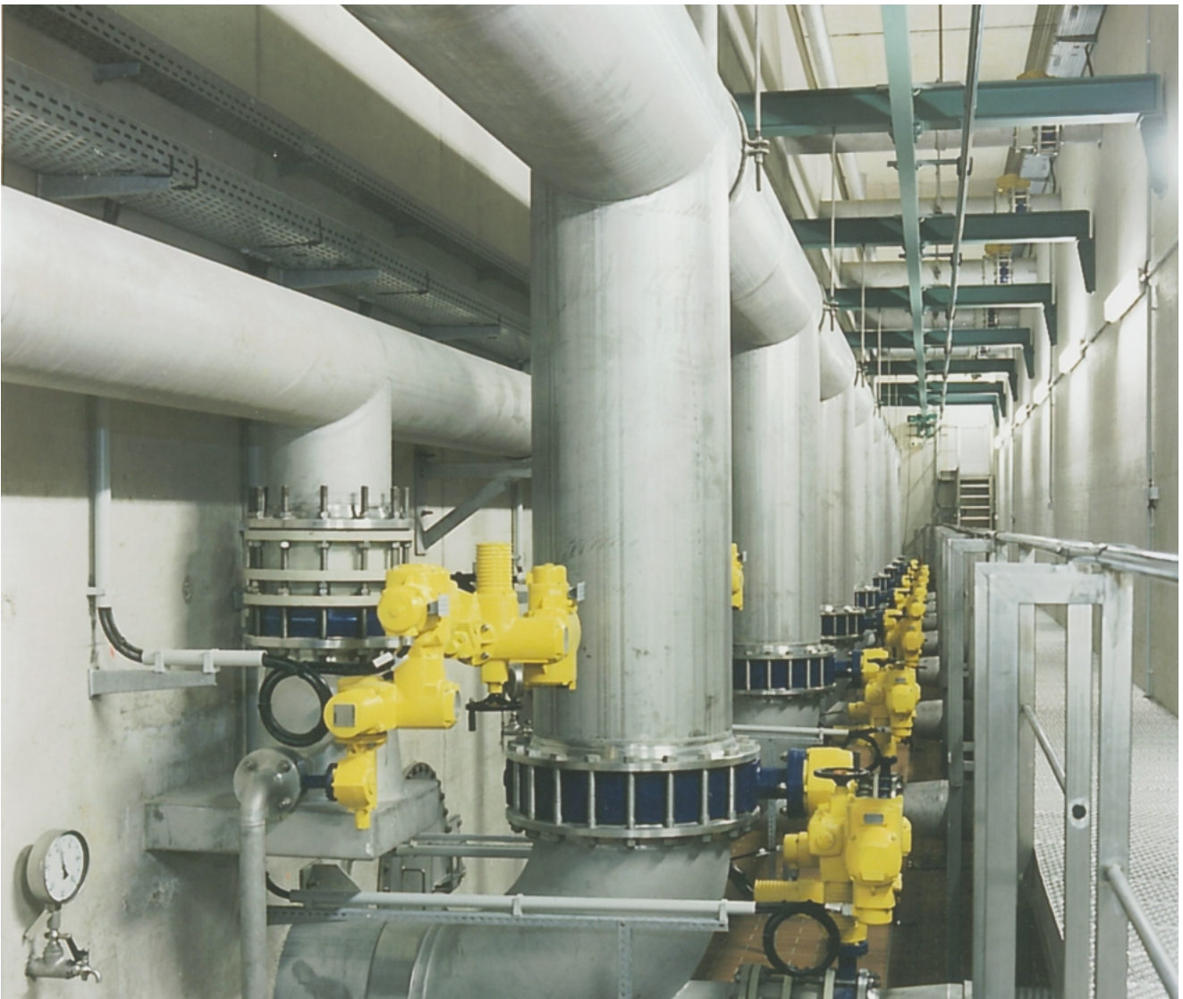
Bild 12: Verteilerrohre aus Edelstahl Rostfrei in einer Abwasserbehandlungsanlage (Foto: H. Butting GmbH & Co. KG, Knesebeck)
