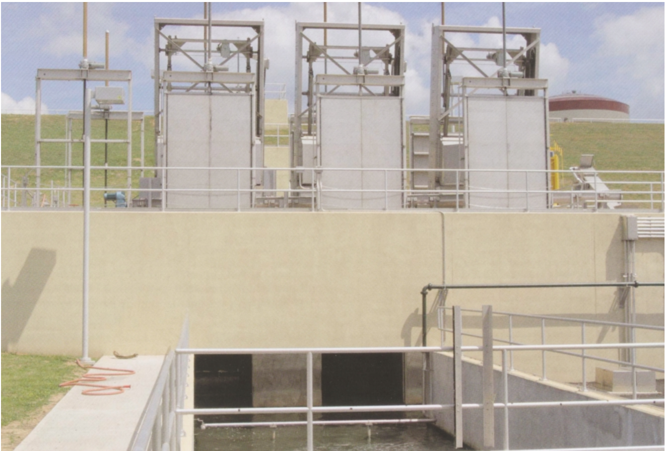
Bild 13: Schieber aus Edelstahl Rostfrei zwischen zwei Abwasserbecken (Foto: Nickel Institute, Toronto)
